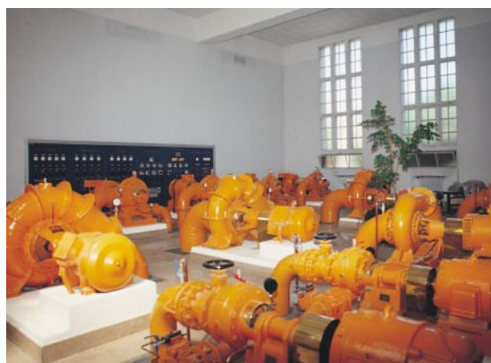
Salle des pompes
