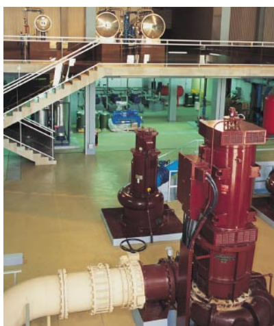
Salle des pompes
